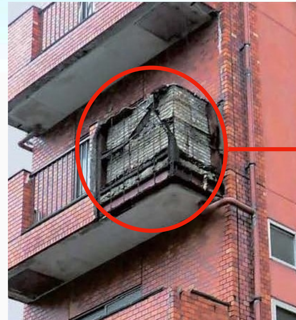
バルコニーの外壁が剥離・落下している様子（福岡市）
